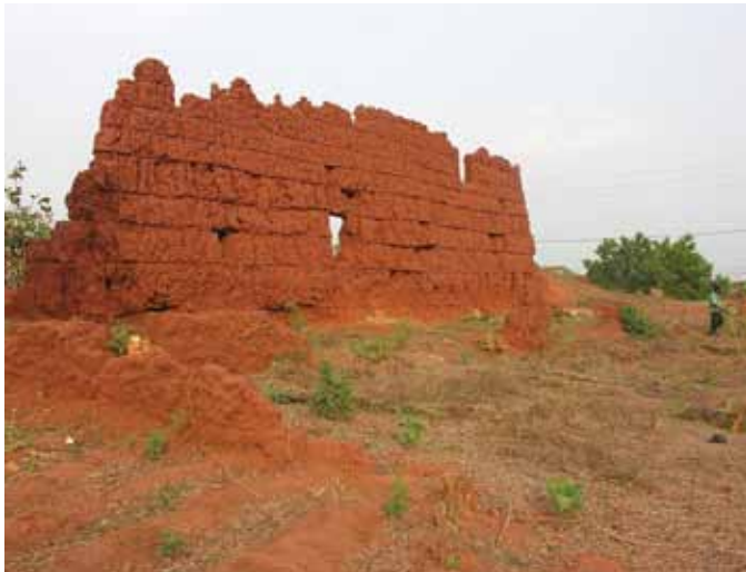
FIGURE 7 Mur vestige de la case à étage du roi Akaba, un des seuls éléments complètement authentique des palais, dont il faut donc prendre le plus grand soin.
