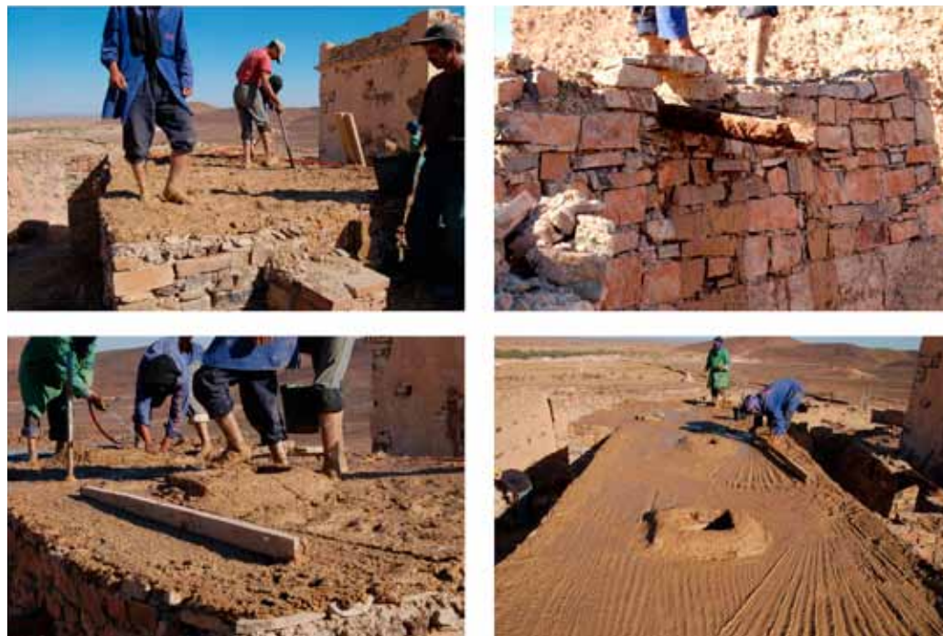
FIGURE 5 Compétence d'édifier : le corps à l'œuvre pour terminer les couvertures. Photos © S. Naji
