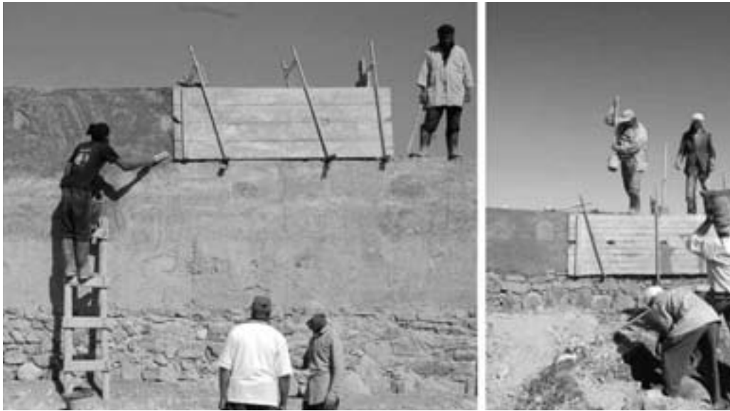
FIGURE 3 Restitution de l'ancien rempart, double paroi en pierre et en pisé. Mise en œuvre du pisé d'Assa : damage dans la banche sur assise de pierres. Photo © S. Naji
