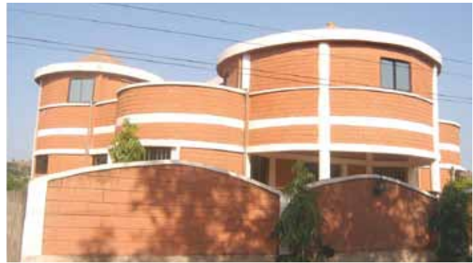
FIGURE 8 Une takienta en parpaings de ciment. Photo : Direction du patrimoine culturel du Togo
