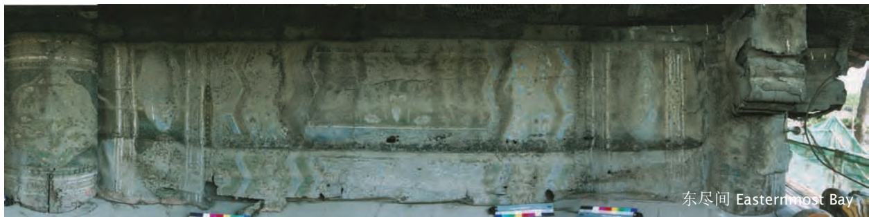
东尽间：大额枋上彩画有污迹一较大水平裂缝，底部空鼓。小额枋彩画完全空鼓，底部局部脱落并凸出来。
