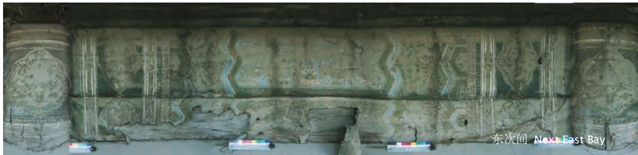
东次间：大额枋彩画除污迹及表面风化外，以稳定状态完整的保存了下来。小额枋彩画部分脱落，风化，空鼓，并且凸出来。东侧挑尖梁头彩画空鼓，呈悬挂下垂状态（照片上看不到）。
