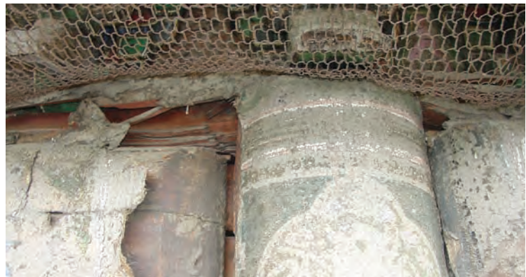
平板枋的开裂导致了第二间及第三间之间的彩画脱落。
