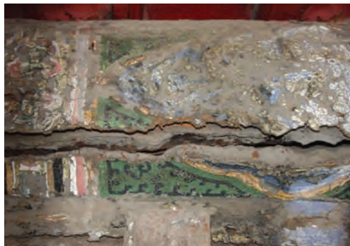
挑檐檩上的裂缝。
