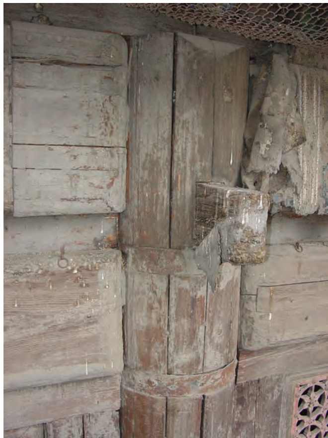
西次间西侧檐柱细部照片体现出其上彩画几乎全部脱落。
