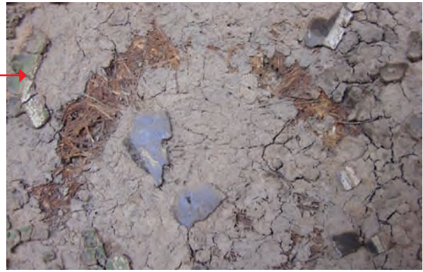
彩画层细部，显示出严重的风化。大量的颜料层与表层地仗脱落暴露出了其下的纤维层。
