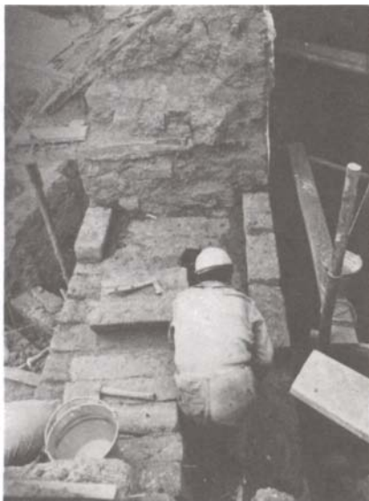
Las técnicas que pueden ser correctas para la consolidación de los muros de adobe, pueden afectar la pintura mural.
