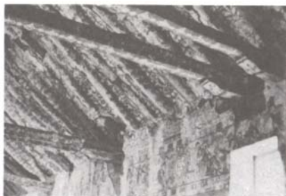
Dramático estado de conservación de la mayor parte de las iglesias decoradas con pintura mural.
