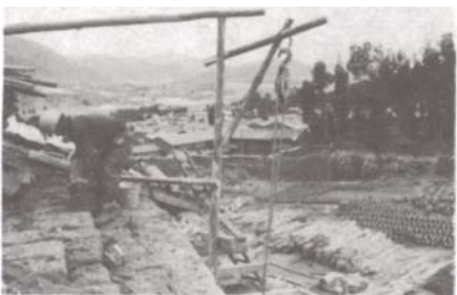
Es imprescindible preservar la edificación antigua para salvar la pintura mural que es parte de ella.
